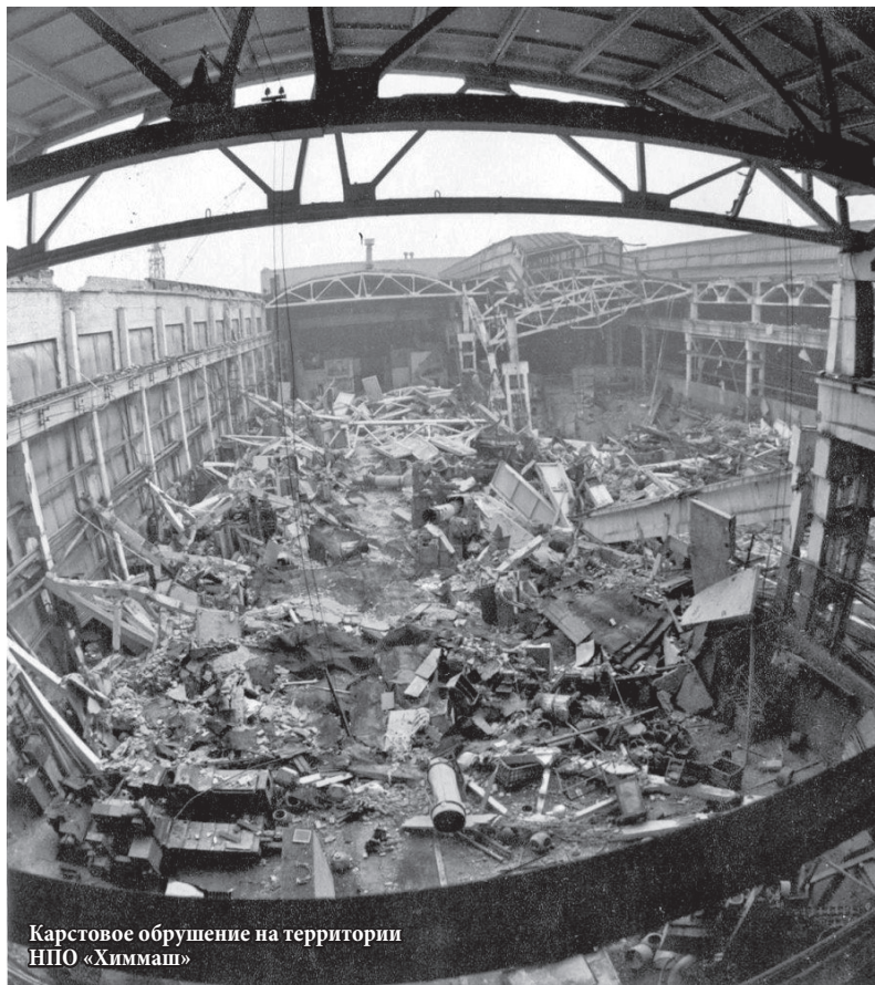
Карстовое обрушение на территории НПО «Химмаш»
